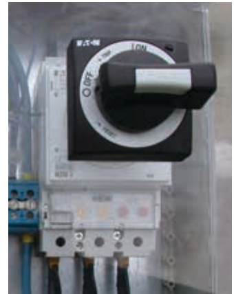
An präsezierter Stelle auf der Instrumententafel installierte Kemper den Eaton Leistungsschalter NZMN2-VE250 – hier kombiniert mit einem Drehgriff zum Ein- und Ausschalten (Quelle: Kemper)
